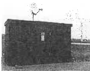
poste de livraison
